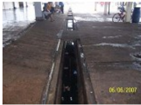
Gambar 5.6. Saluran air yang tidak diperhatikan kebersihannya
